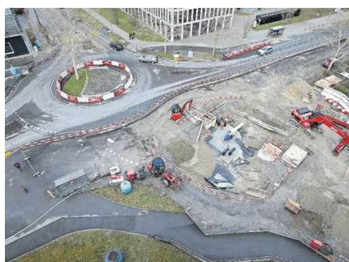
Der provisorische Kreisel bei der Aabachstrasse wird an den ursprünglichen Standort versetzt.
